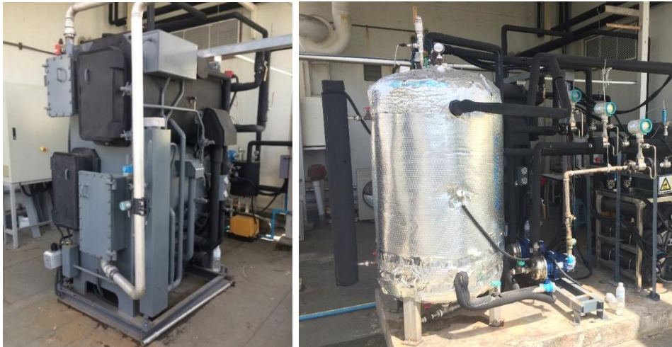
รูปที่ 16: เครื่อง Absorption Chiller (รูปซ้าย) และถังน้ำร้อน (รูปขวา)
