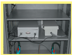
รูปที่ 3 ชุดควบคุมการวัดและวงจรแปลงสัญญาณ
