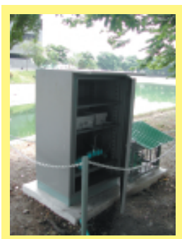
รูปที่ 2 ตู้ที่นำไปติดตั้งตามแหล่งน้ำต่างๆ
