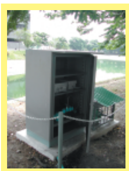
รูปที่ 2 ตู้ที่นำไปติดตั้งตามแหล่งน้ำต่างๆ
