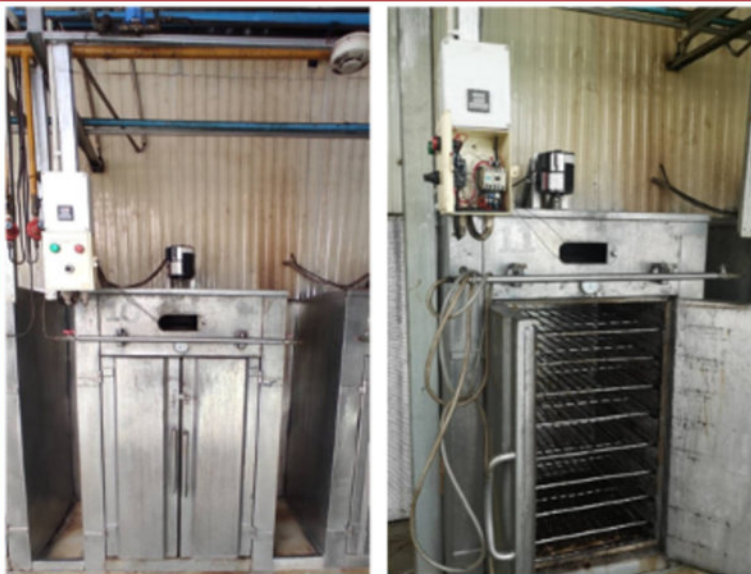
ระบบเดิมในการทำงานใช้ระบบ GAS LPG ในการทำความร้อน
