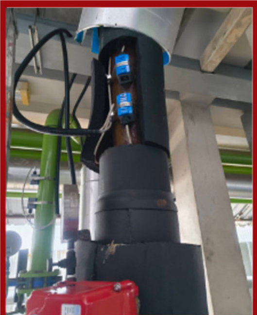
ภาพระบบทำน้ำเย็น Chiller
