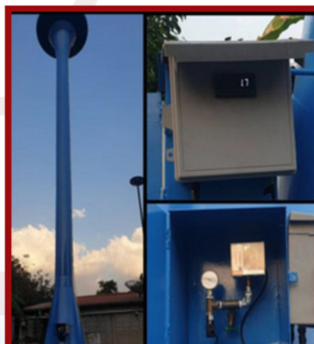
ภาพท่อส่งจ่ายน้ำ
