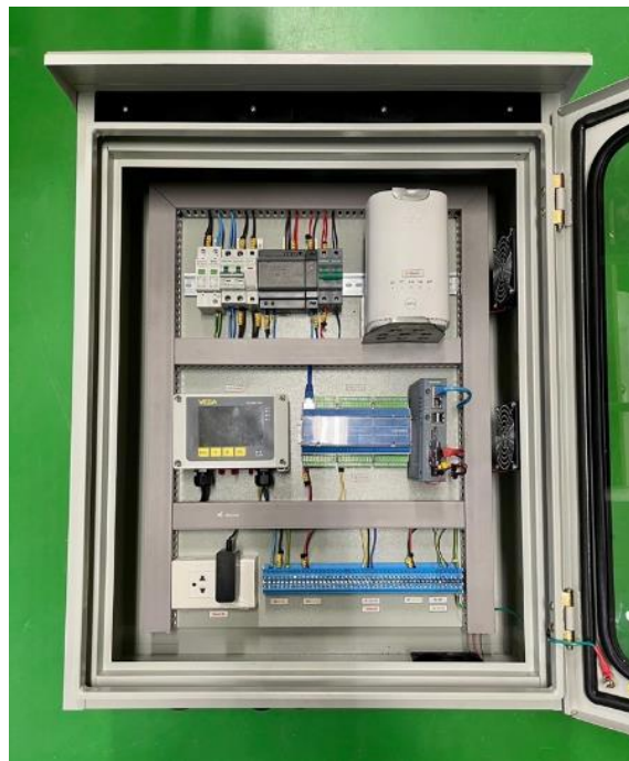
ภาพที่ 4.13 แสดงตัวอย่างการจัดเรียงอุปกรณ์ภายในตู้ควบคุมเซนเซอร์ที่เชื่อมต่อเครือข่าย 5G ผ่าน 5G CPE
